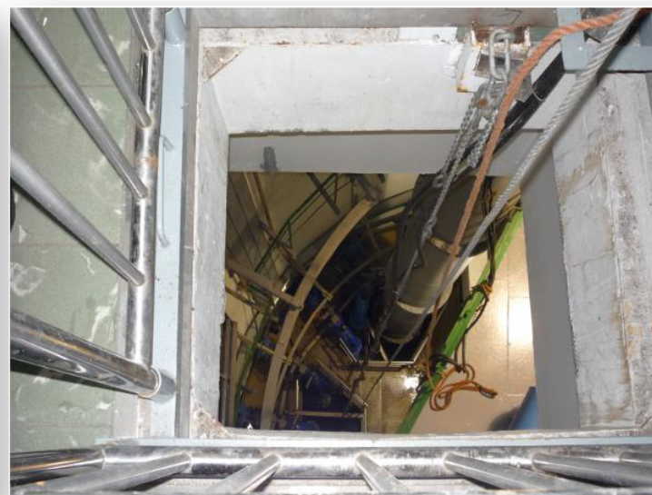
Maszynownia ujęcia wody
